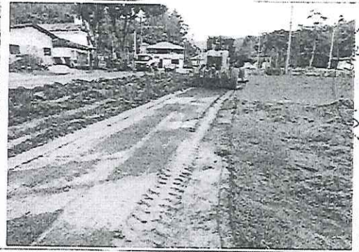
DESMATAMENTO E LIMPEZA MECANIZADA DE TERRENO COM REMOÇÃO DE CAMADA VEGETAL, UTILIZANDO TRATOR DE ESTEIRAS
