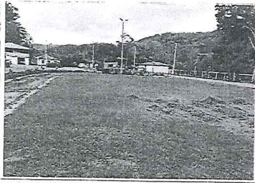
DESMATAMENTO E LIMPEZA MECANIZADA DE TERRENO COM REMOÇÃO DE CAMADA VEGETAL, UTILIZANDO TRATOR DE ESTEIRAS
