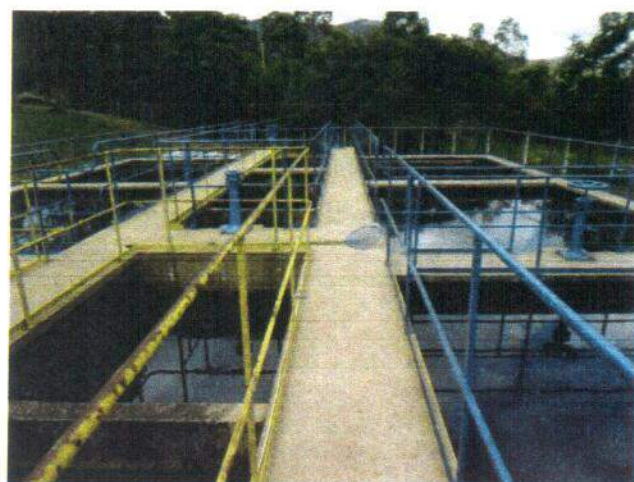
Foto 5.51 – Unidades da ETA Sul (2)
