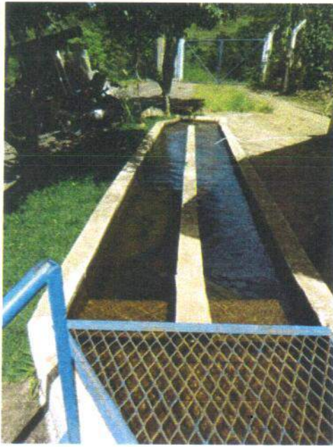
Foto 5.23 – Unidades da ETA Mata do Seminário (1)
