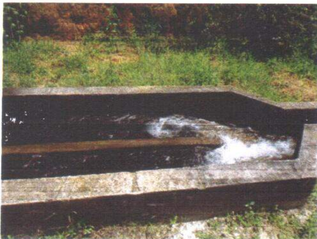
Foto 5.36 – Caixa de areia
