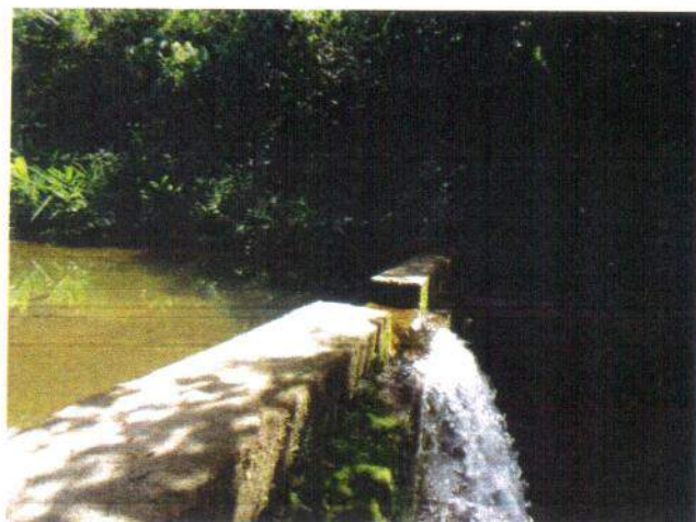
Foto 5.18 – Barragem de nível
