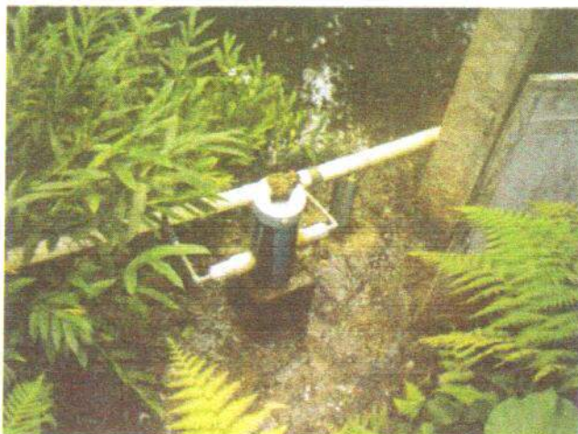
Foto 5.16 – Antigo clorador instalado na captação Maquiné
