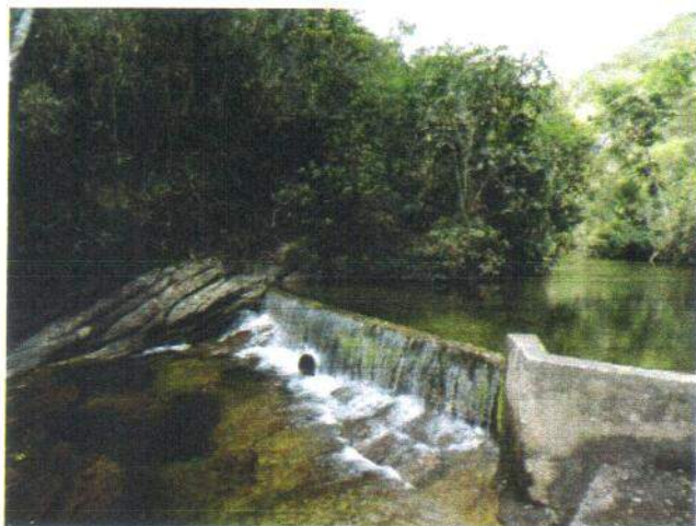
Foto 5.42 – Barragem de nível (1)
