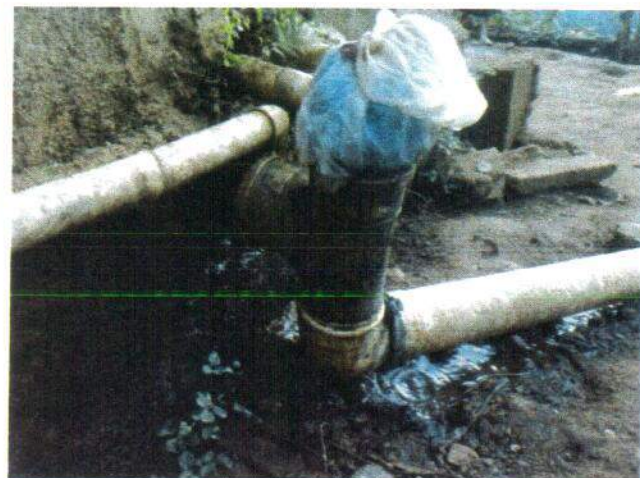
Foto 5.59 – Rede de abastecimento de água do subdistrito de Barroca (2)
