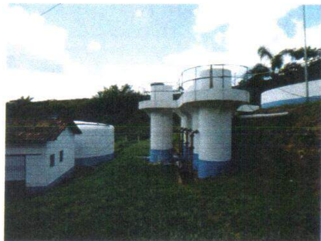
Foto 5.20 – Vista da ETA Mata do Seminário (2)
