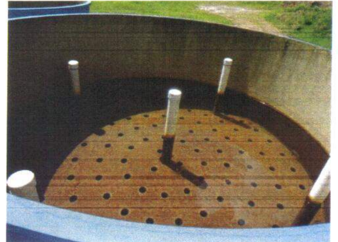
Foto 5.32 – Floculador da ETA Matadouro
