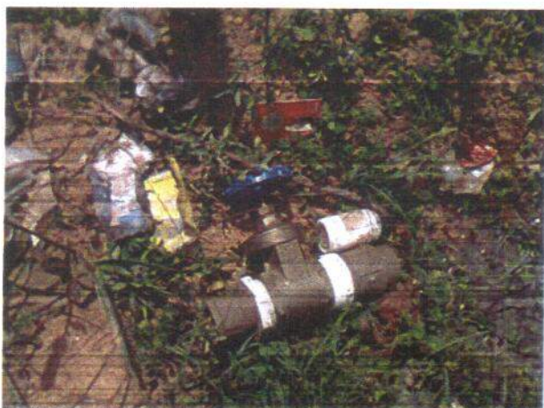
Foto 5.62 – Sistema de abastecimento de água do subdistrito Constantino (1)
