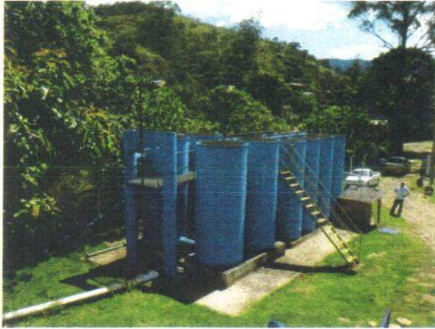
Foto 5.29 – Vista da ETA Matadouro
