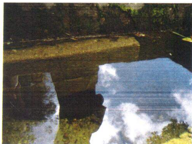
Foto 5.45 – Adutora da Captação Serrinha 2
