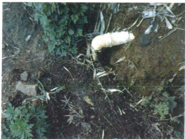
Foto 5.58 – Rede de abastecimento de água do subdistrito de Barroca (1)
