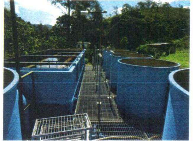
Foto 5.30 – Unidades da ETA Matadouro
