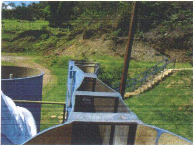
Foto 5.31 – Chegada de água bruta na ETA Matadouro
