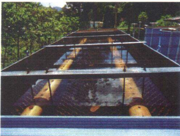
Foto 5.33 – Decantador da ETA Matadouro
