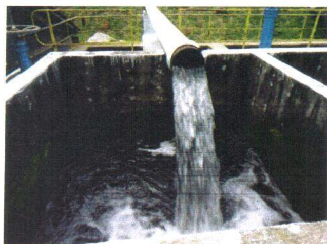
Foto 5.47 – Chegada de água bruta na ETA Sul
