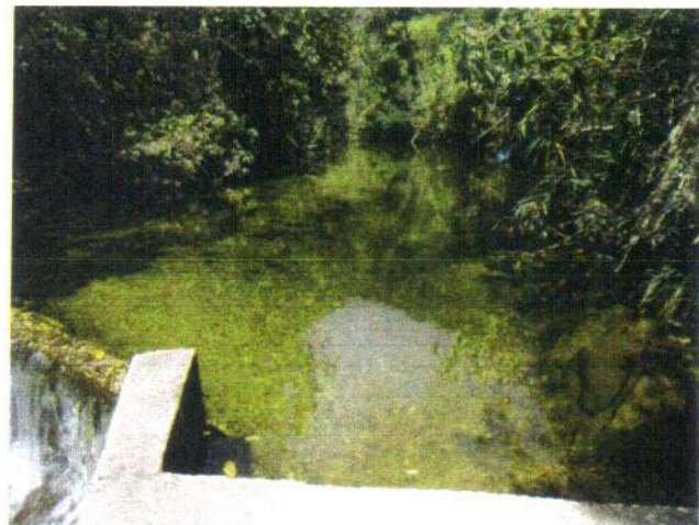
Foto 5.43 – Barragem de nível (2)
