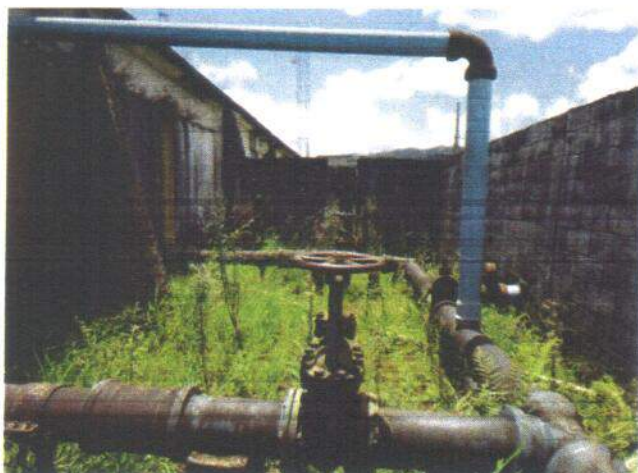
Foto 5.27 – Tubulações de distribuição de água do Reservatório Monsenhor Horta
