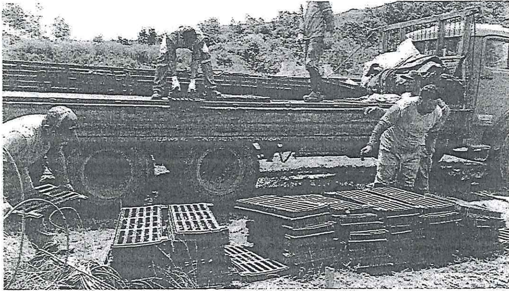
Boca de lobo
